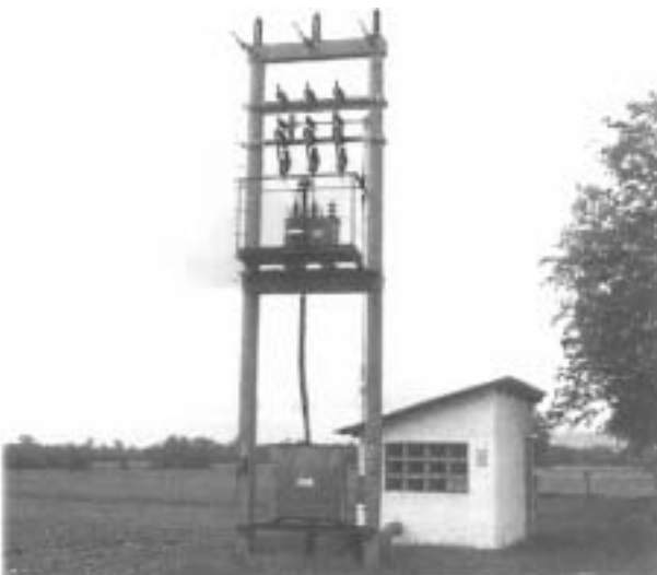
Pumpenhaus mit Trafostation in Marchegg
