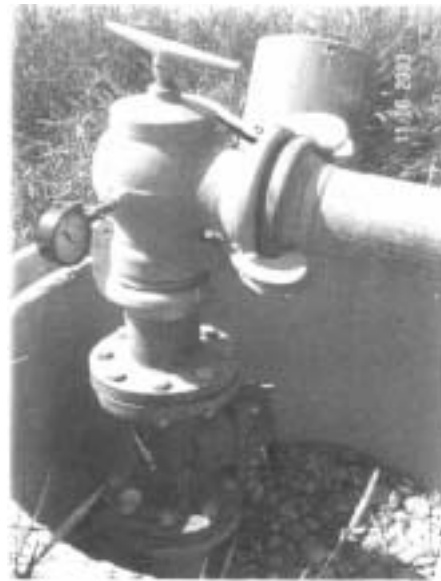
Entnahmehydrant mit Wasserzähler und Absperschieber
